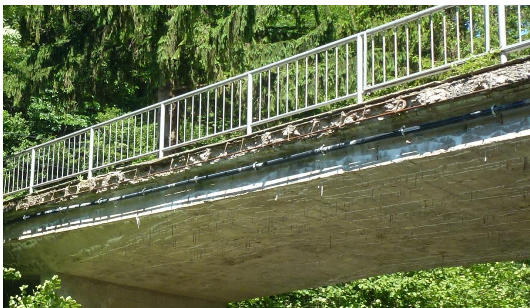
Slika 10: Robni venci na večjem delu objekta (na južni strani) razpadli in jih razen ostankov armature več ni
