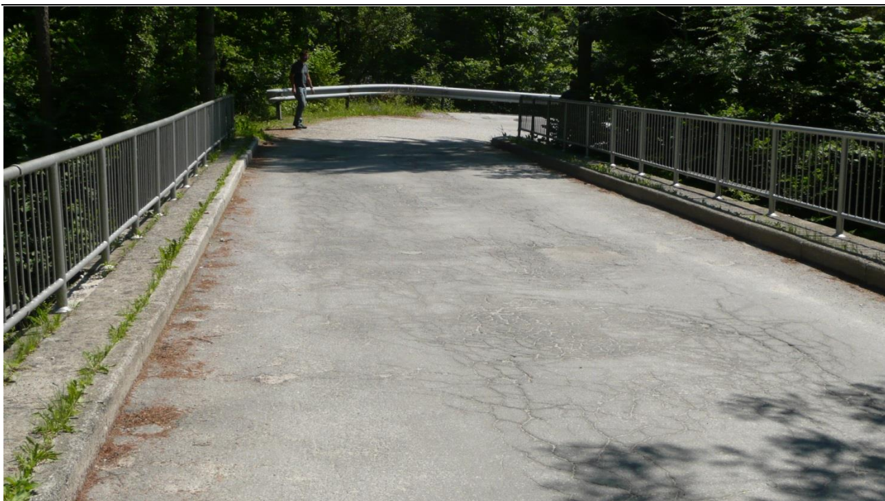
Slika 8: Asfalt na vozišču je razpokan, hodniki z robnimi venci so v slabem stanju
